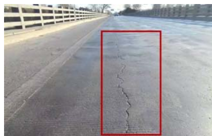
图1 桥梁表面出现裂缝
