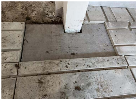
图11 供暖管铺设障碍部位
